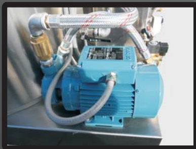
Pompa di alimentazione
