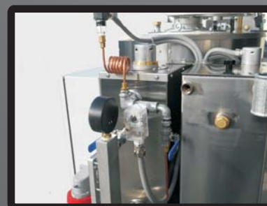
Strumentazione di controllo
