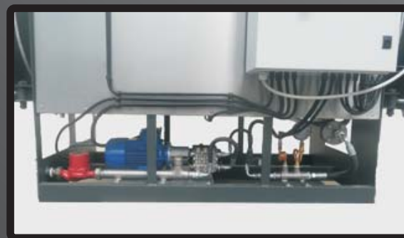
Gruppo pompe, flussostato e manometro
